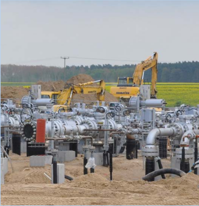
Kugelhähne im Erdgasfeld ball valves in natural gas area
